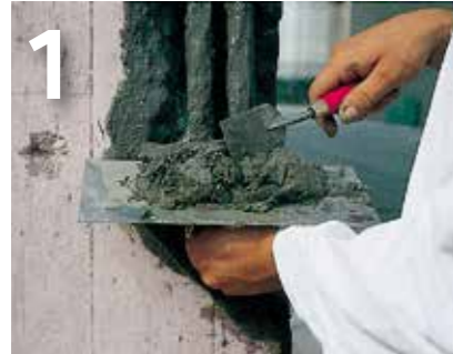
1 Prüfung Zustand Fundamentsockel ggf. Betoninstandsetzung.
